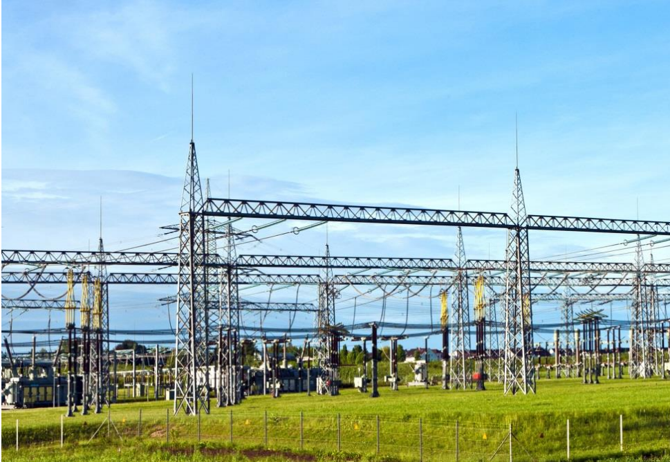
Figur 2: Eksempel på lynfangermaster på en transformerstation (øverst på de netformede transformatorårne).
